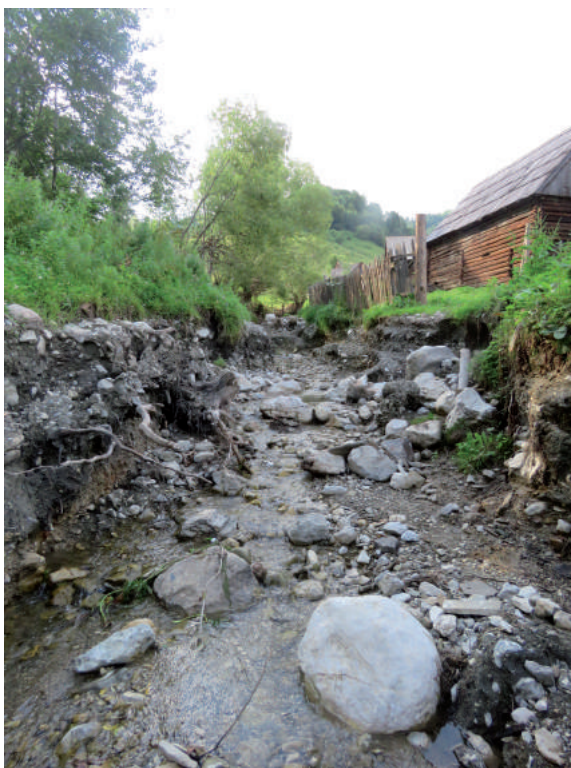
6. kép A növekvő intenzitású csapadék, viharok alkalmával a meredek oldalakon lezúduló jelentős mennyiségű víz nagy károkat okoz a településen, a házakban és az infrastruktúrában. Előfordul, hogy a hirtelen lezúduló esővíz a burkolatlan utakat másfél méter mélyen is kimossa. Fénykép: Babai Dániel.
